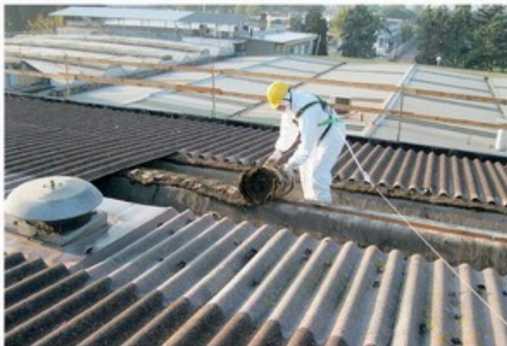
Un intervento di bonifica dall'amianto su un edificio. Nella provincia restano 27 siti pubblici da bonificare
