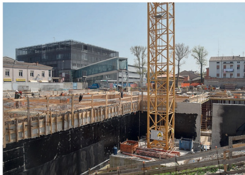
Il cantiere del Blocco B dell'ospedale di Fiorenzuola. E' iniziata la costruzione del piano terra FOTO MENEGHELLI
